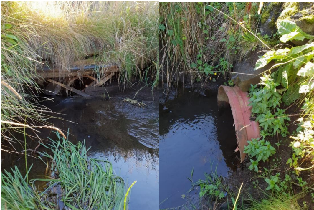
Mynd 6 Ræsi undir Norðurnesveg - norður. Inntak til vinstri og útrás til hægri.
