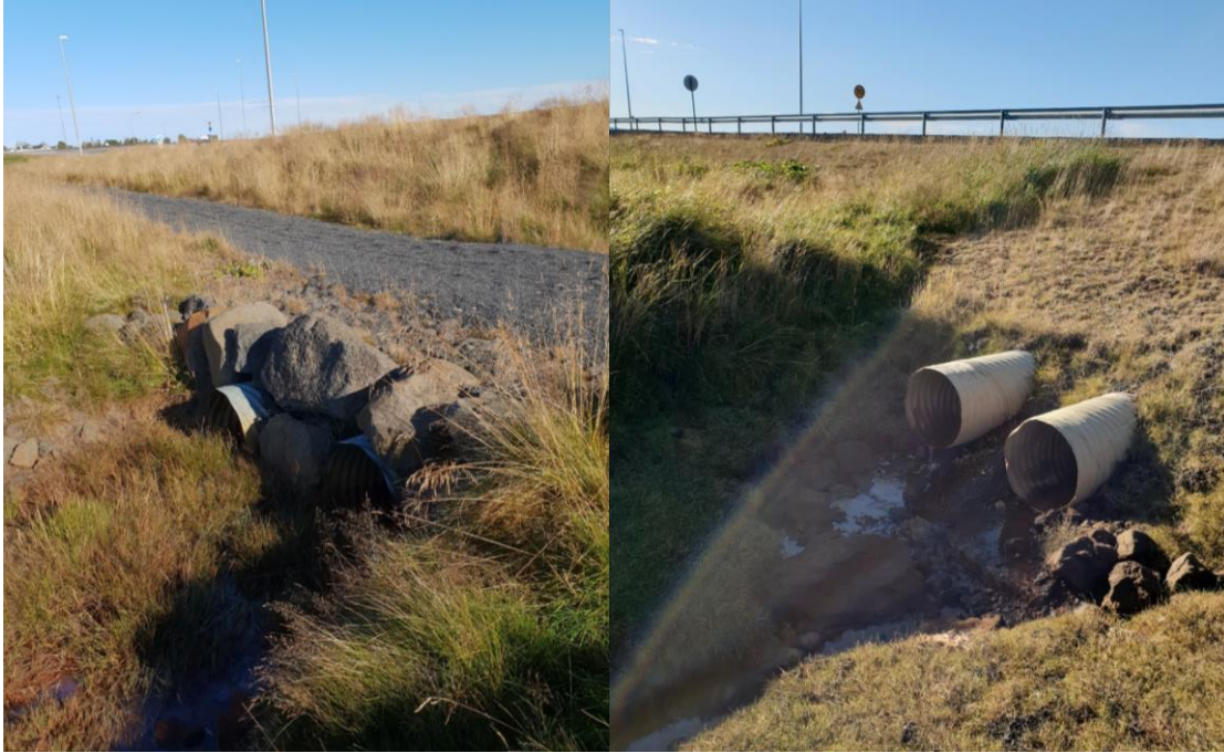
Mynd 7 Ræsi undir Álftanesveg - suður. Inntak til vinstri og útrás til hægri.
