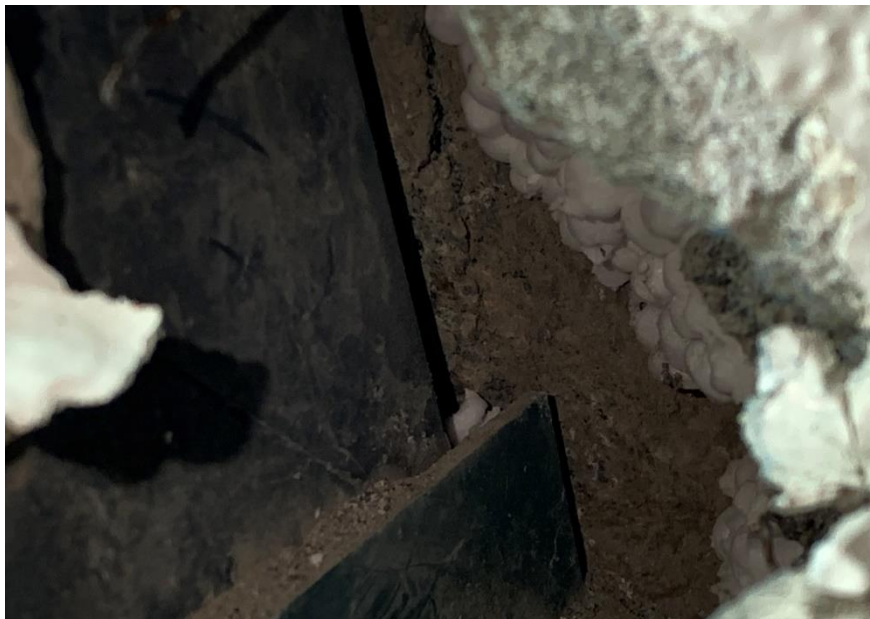
Mynd 8 Þétting lóðrétt þétting að innan. Staðsetningu má sjá á teikningu.
