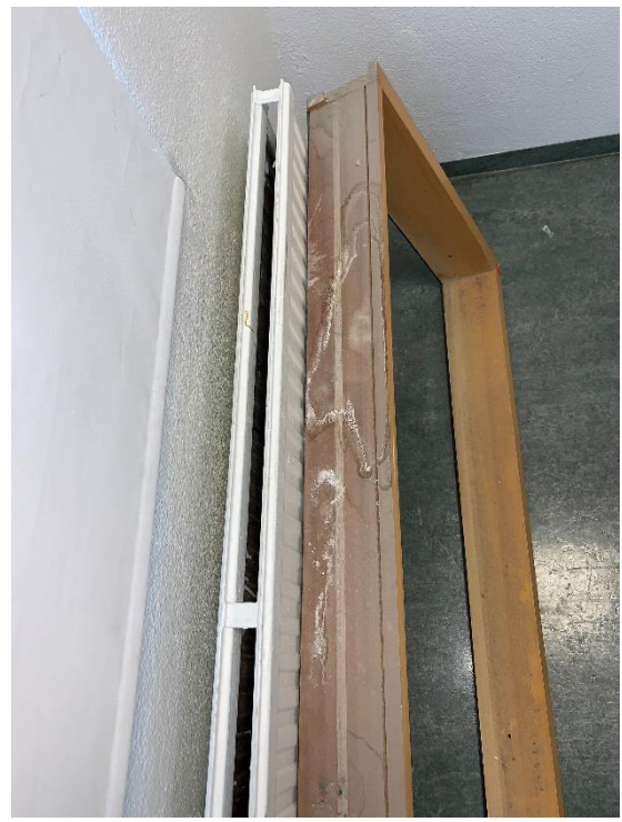
Mynd 12, Sést hvar vatn hefur lekið á ofanvert karmstykki
