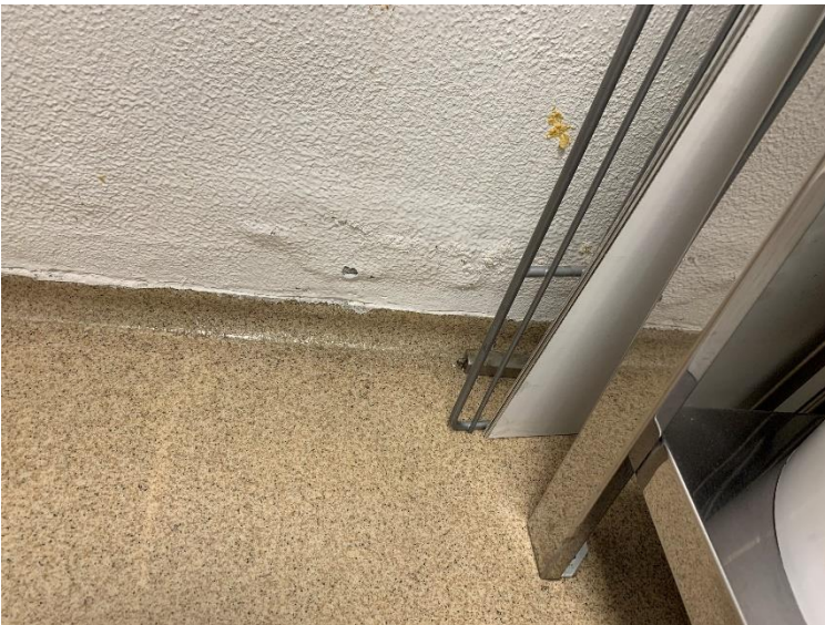
Mynd 9. Eldhús útfellingar mögulega frá þakglugga hinumegin við vegginn (sjá mynd 7)
