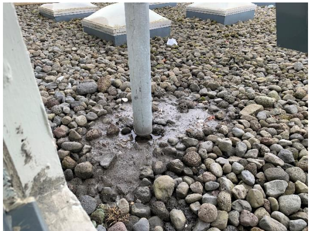
Mynd 14. H2 flatt þak austur mikil efja sem þarf að hreinsa svo vatn geti flætt óhindrað.
