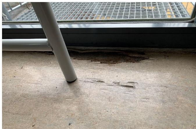
Mynd 4. H2 viðbygging flóttaleið. Sýni E-15
