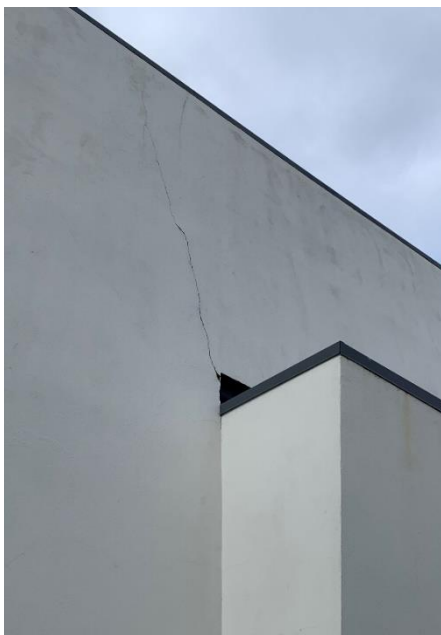
Mynd 3. sprunga fyrir ofan stigapall
